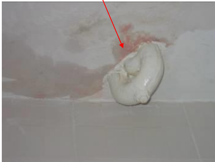
樓上單位地台損壞
