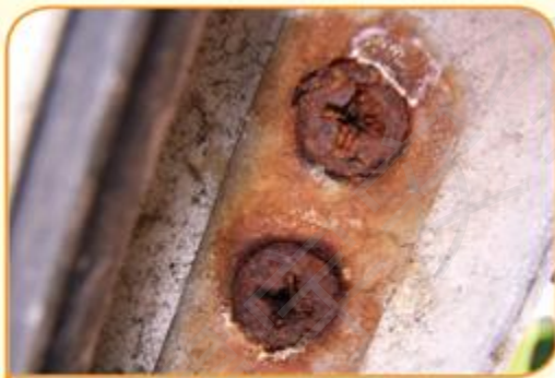
→ 窗扇頂部及底部的鉚釘/螺絲損毀、鬆脫、生銹或缺漏
