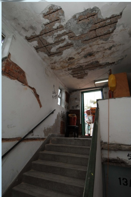
石屎爆裂，鋼筋外露
