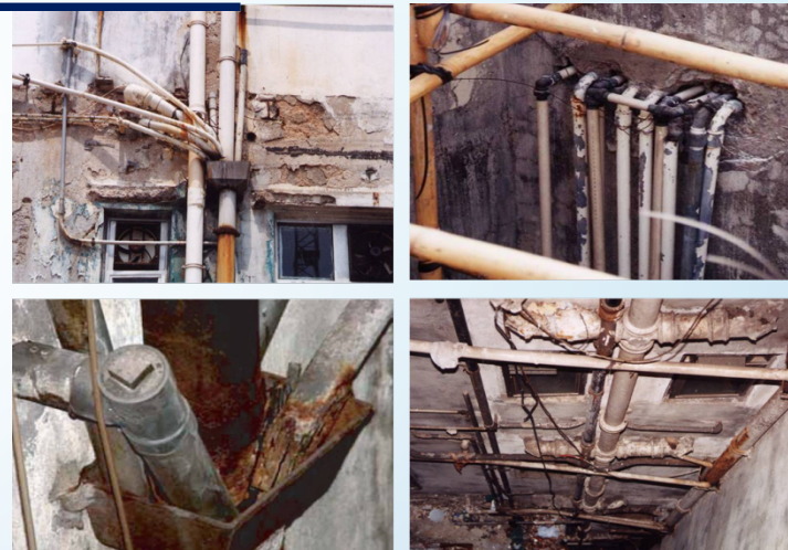
供水及排水系統破損、失修
