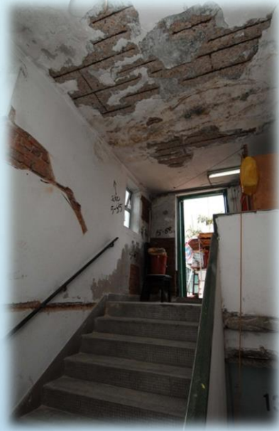
石屎爆裂，鋼筋外露
